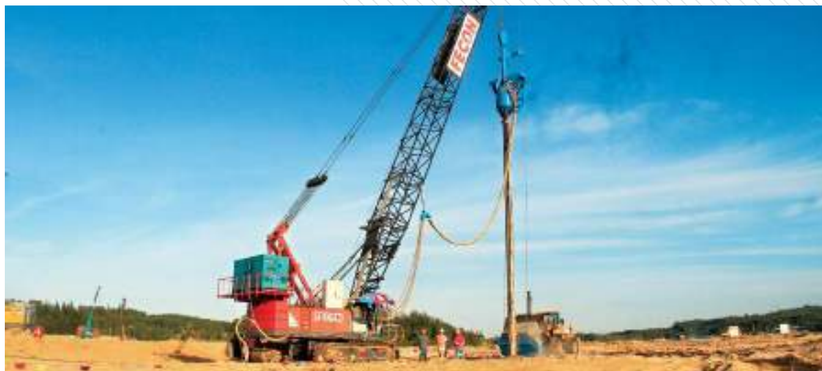
Nhà máy thép Hòa Phát Dung Quất (Quảng Ngãi) - Thi công đầm rung
