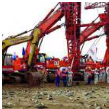
Ảnh 3 + 4. Nhiệt điện Thái Bình Xử lý nền bằng phương pháp thi công cắm bắc thấm kết hợp gia tải hút chân không
