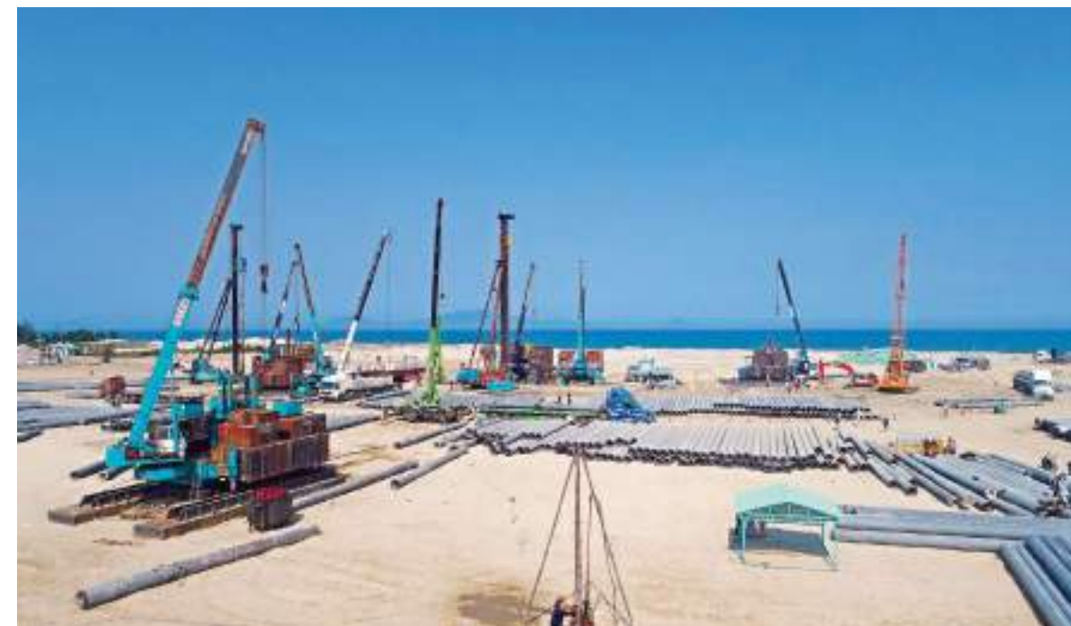
Hoiana (Nam Hội An) – Khu Phức hợp nghỉ dưỡng, Casino, Sân golf Cung cấp, thi công cọc PHC D350, D500, khoan dẫn
